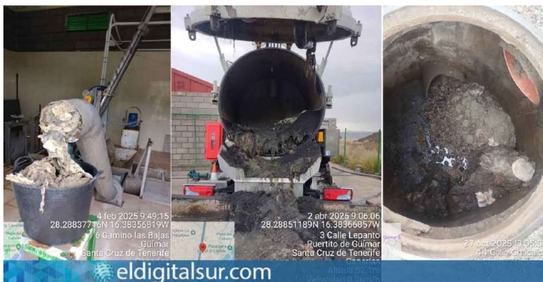
Extracción de 15 toneladas de basura y toallitas de las alcantarillas de Güímar durante la campaña de mantenimiento / EDS
